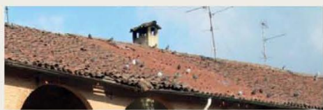
Degrado del manto di copertura e cedimento della struttura portante del tetto
